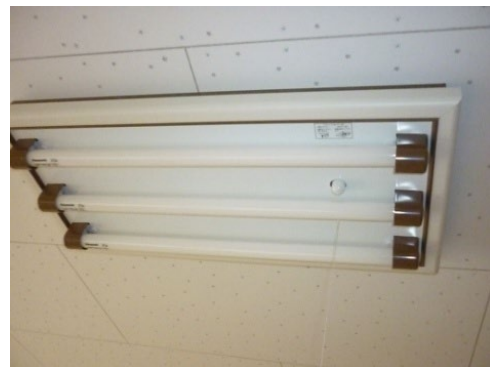
居室照明器具（20W）
