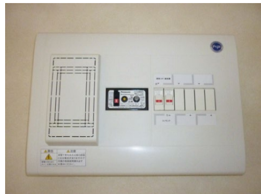
居室分電盤（ブレーカー）
