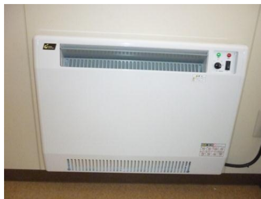
21. トイレ用電気パネルヒーター
