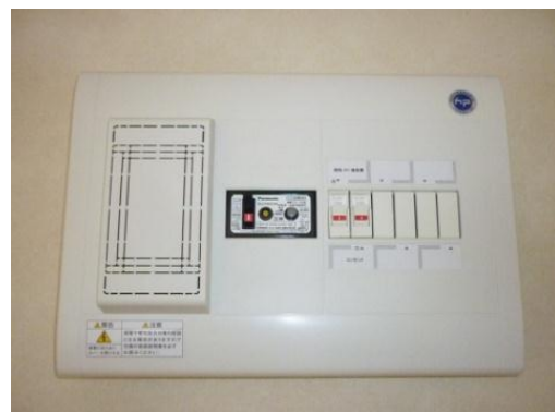
居室分電盤（ブレーカー）
