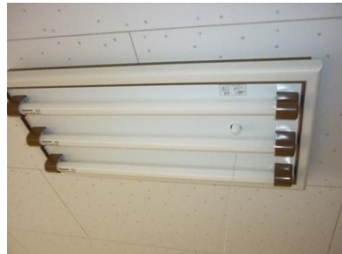
居室照明器具（20W）
