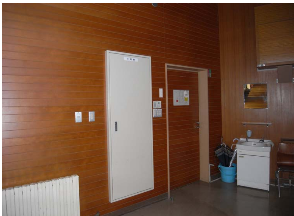
車いすの通過が困難な狭い片開き戸
