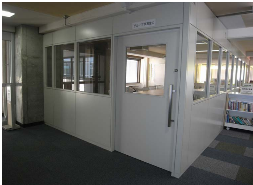
グループ学習室には引き戸を設置した
