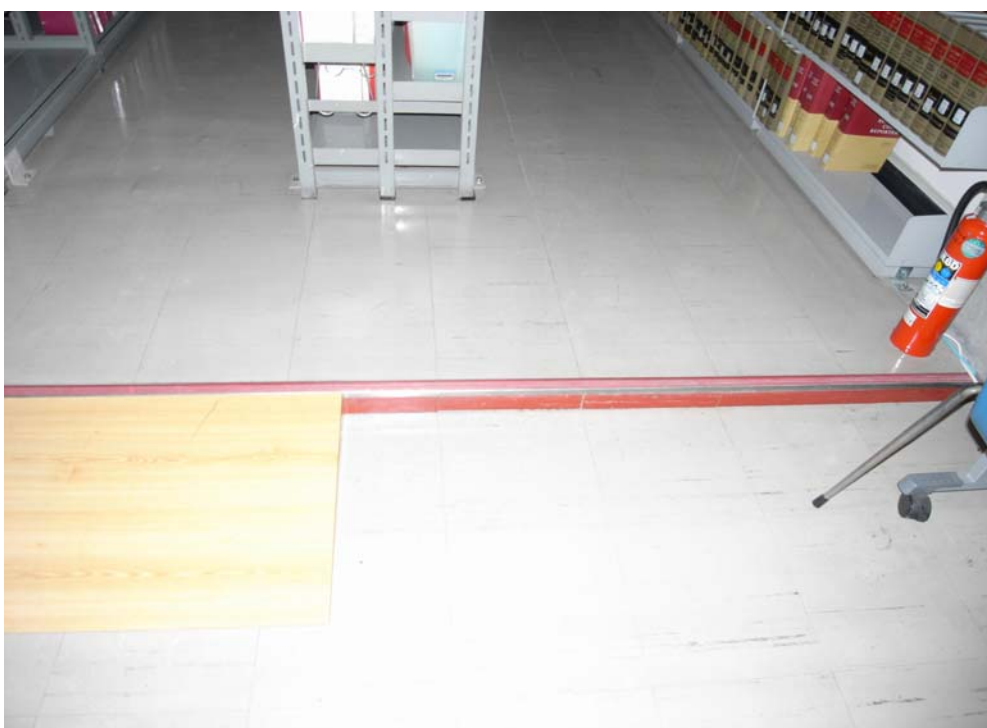
段差があり、危険な通路
