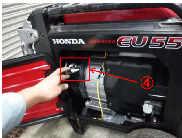
図4 発電機側面内部
